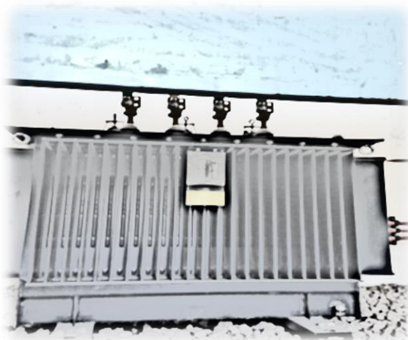
Foto 1: Imagen de un transformador eléctrico.
